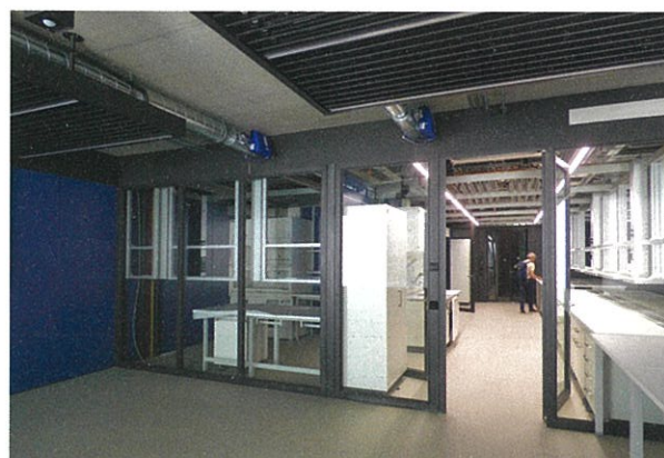
Je tiefer man ins Gebäude eindringt, desto mehr öffnet sich die Gebäudetechnik respektive die Leitungsführung. Ist sie in der Eingangshalle (ganz oben) noch verborgen, zeigen sich in den Fluren an der Decke schon punktuelle Technikelemente. In den Laboren sieht man die Leitungen an der Decke. Aber auch eine Mischung ist möglich, etwa in der Auswertzone der Labore (unterstes Bild).
